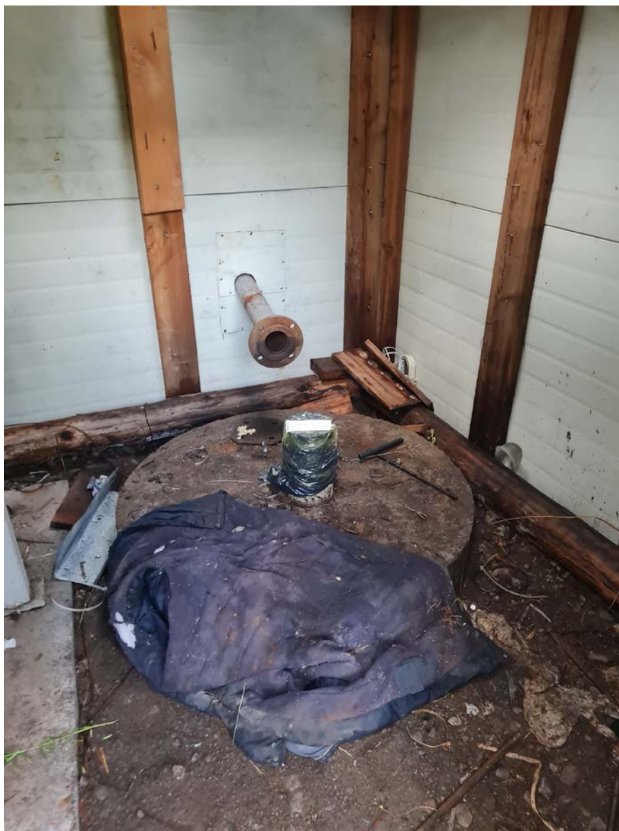
Рис. 1 Оголовок скважины № РЭ-0108
