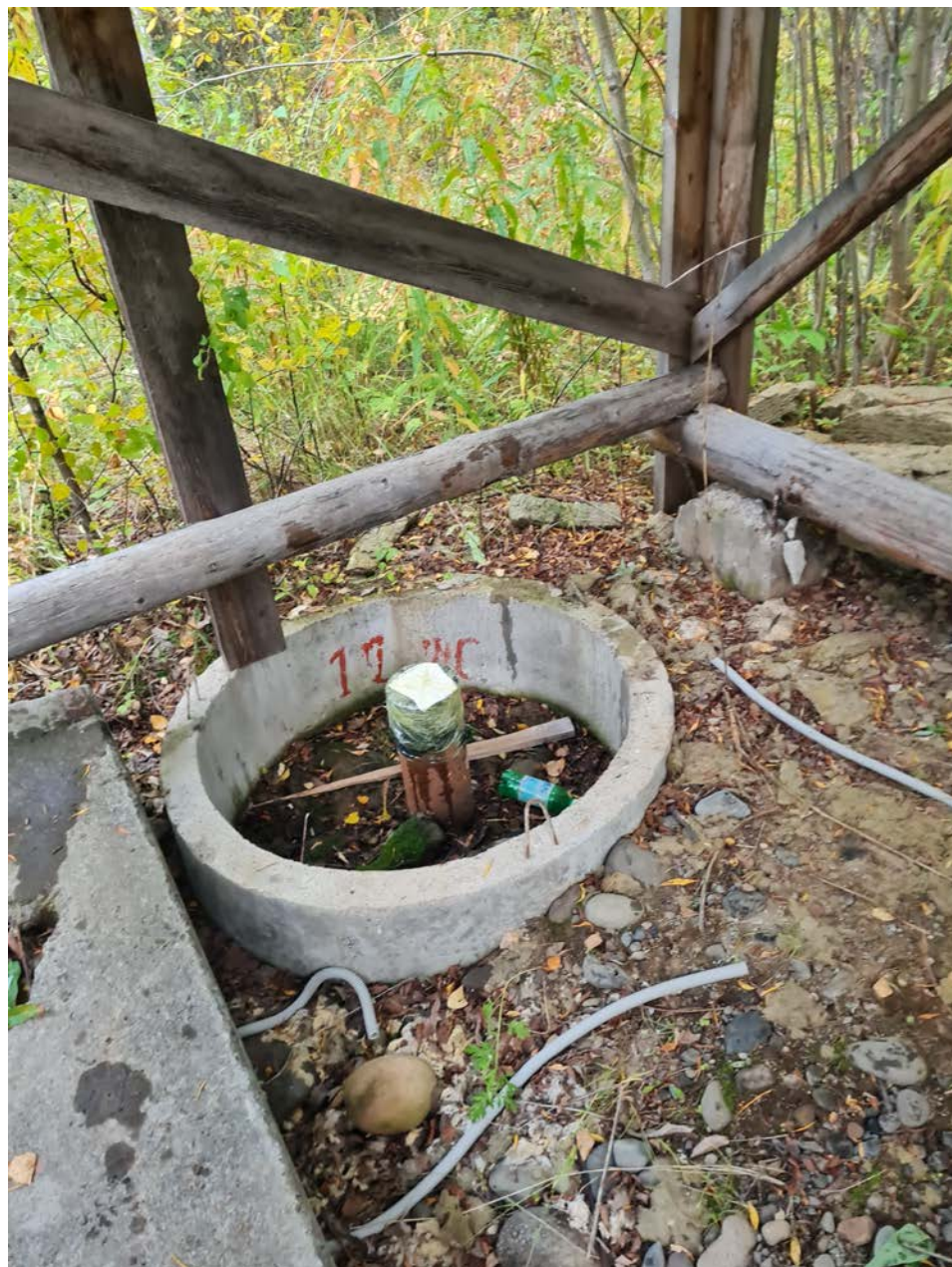
Рис. 2 Оголовок скважины № РЭ-0208
