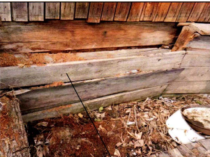
Разрушение забирки и отсутствие отмостки
