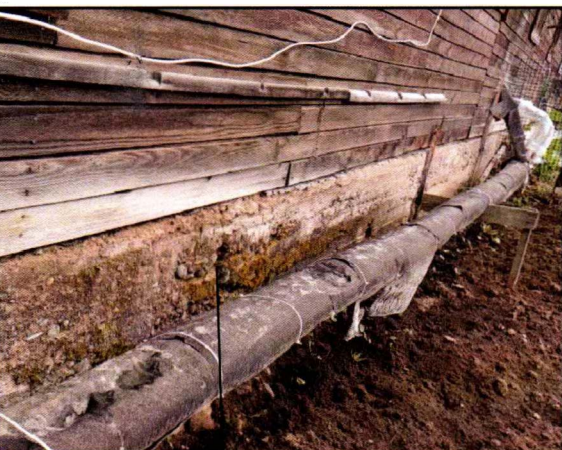
Глубокие трещины в цоколе, неравномерная осадка фундамента
