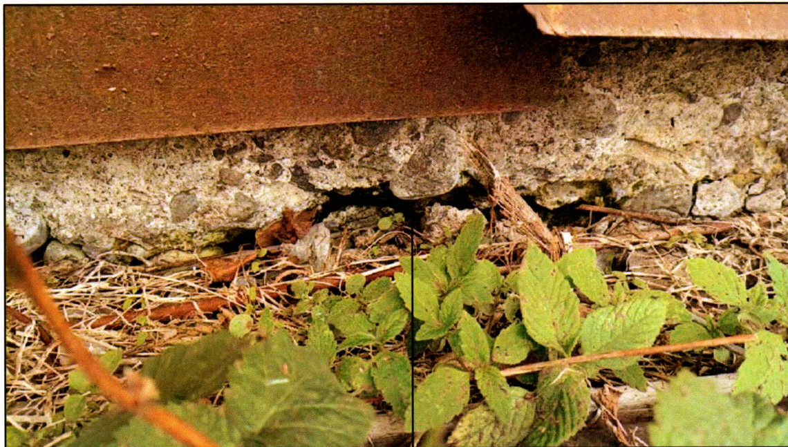
Трещины в фундаментах более 1.5 мм.
