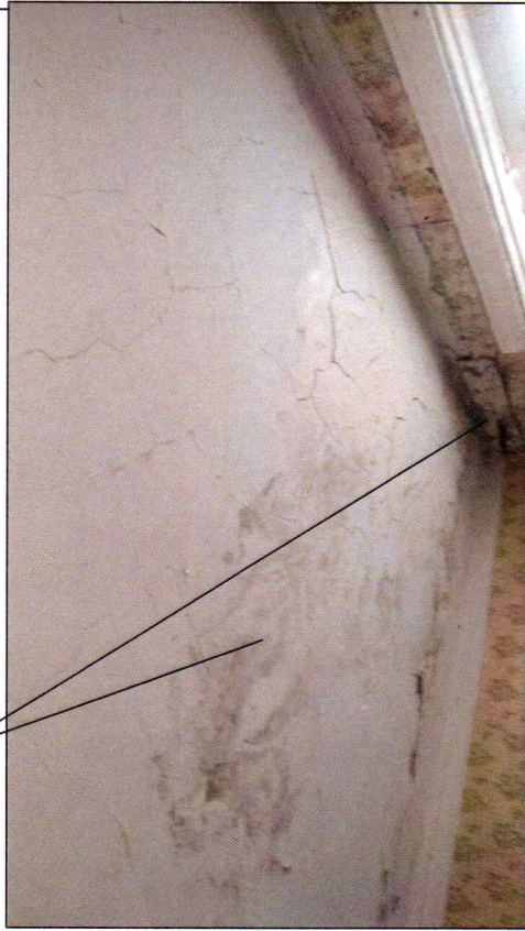
Фото №8 Следы протечек атмосферных осадков через повреждённую кровлю
