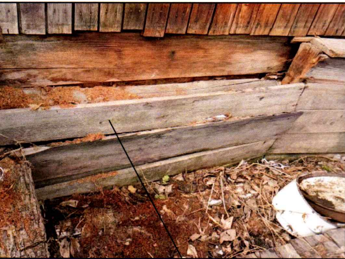
Разрушение заборки и отсутствие отмосткиотмостка
