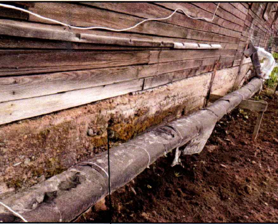
Глубокие трещины в цоколе, неравномерная осадка фундамента
